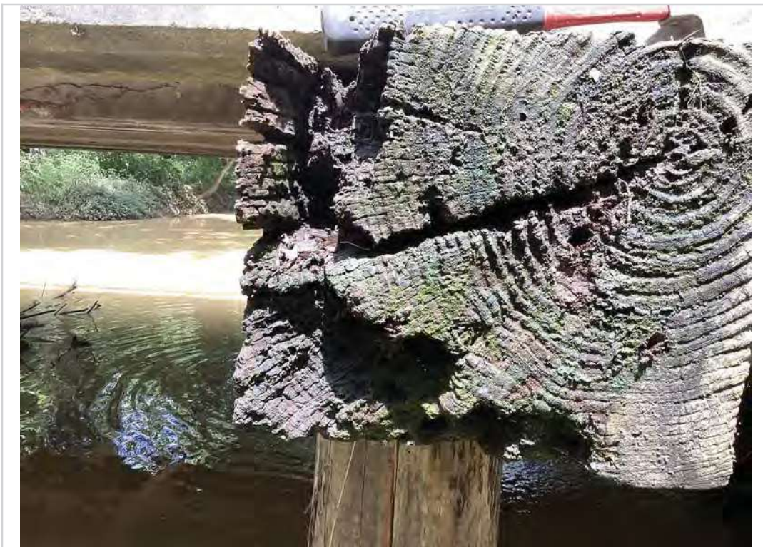
Decay, bent 3 cap
